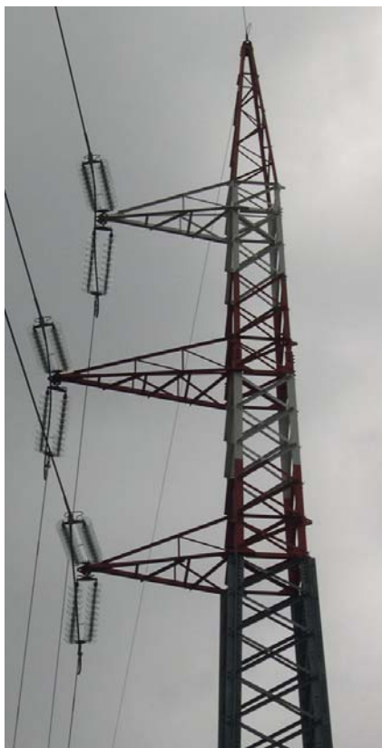
Linea a 132 kV n. 078 “Massa ZI – Strettoia”, sostegno n. 14 in località Cinquale (sostegno in amarro a bandiera sul quale si passa dal conduttore in all.-acc. da 15.85 mm di diametro al conduttore in all.-acc. da 31.5 mm di diametro; 3 mensole sul lato nord)
