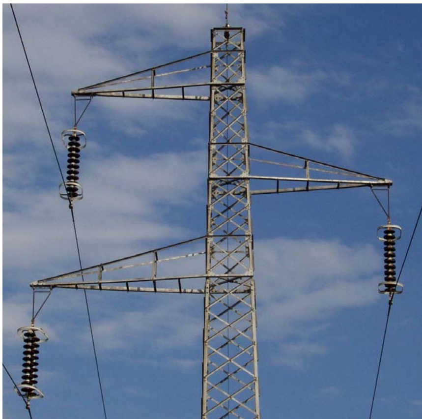
Linea a 132 kV “Massa FS – Cascina FS”, sostegno n. 19 in località Cinquale (tipo TN con conduttore in all.-acc. da 19.38 mm di diametro; 2 mensole sul lato nord)
