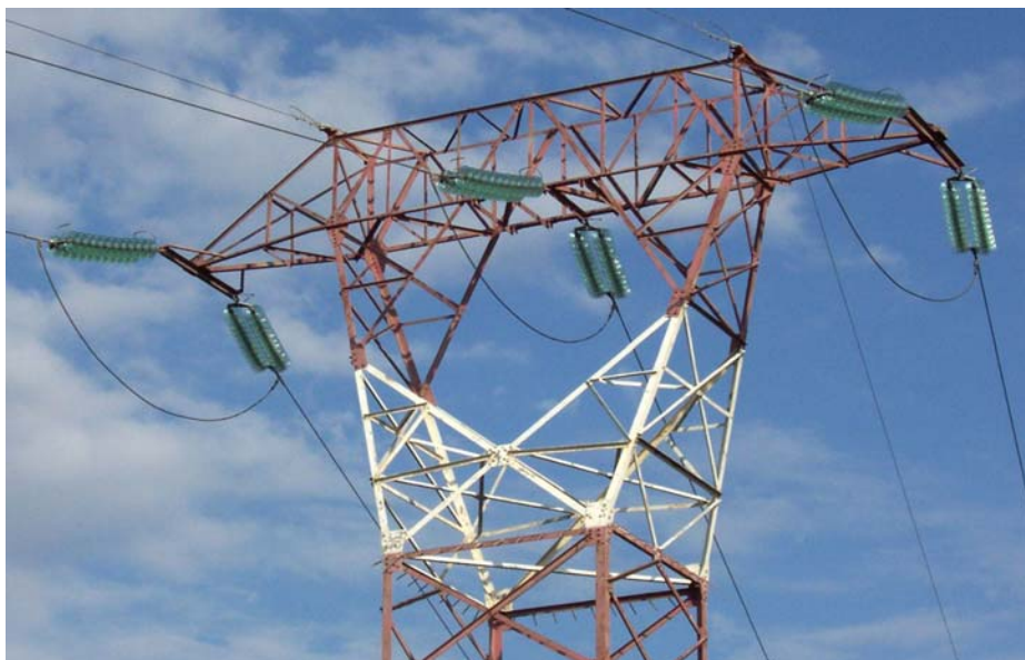
Linea n. 595, sostegno n. 28 in località Cinquale
