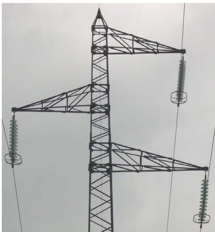
Linea a 132 kV n. 078 “Massa ZI – Strettoia”, sostegno n. 15 in località Cinquale (con conduttore in all.-acc. da 15.85 mm di diametro; 2 mensole sul lato sud)
