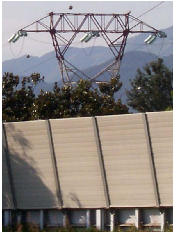
Linea a 132 kV n. 595 “Massa FS – Pietrasanta”, sostegno n. 26 in località Cinquale
